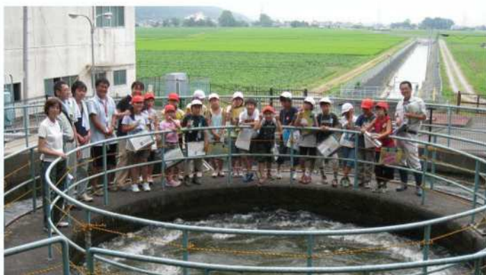
前谷地揚水機場 (円筒分水工)
