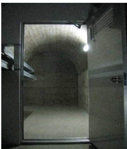
小水力発電施設建屋/アクセスギャラリー境界の扉
