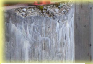
堰柱の劣化(頭首工)
