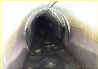
圧カトンネル漏水 (ダム)
