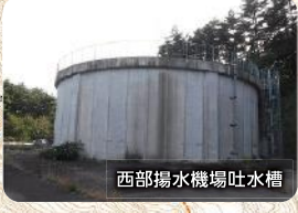
西部揚水機場吐水槽
