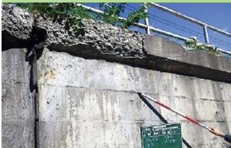
現 状 コンクリート（余水吐）の劣化
