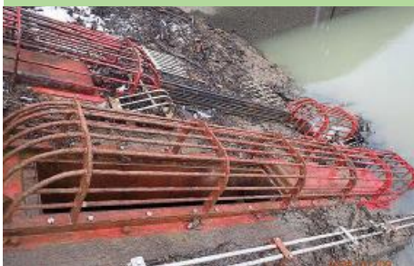
現 状 ゲート設備（取水施設）の劣化
