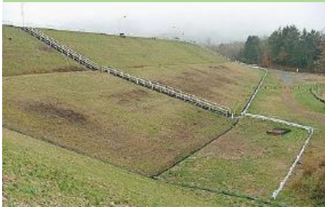
現 状 堤体下流法面に雨水が滞留
