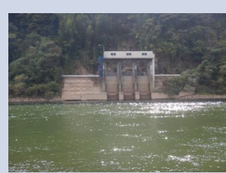
【河川取水ゲート】 中央管理所からの操作 ができない
