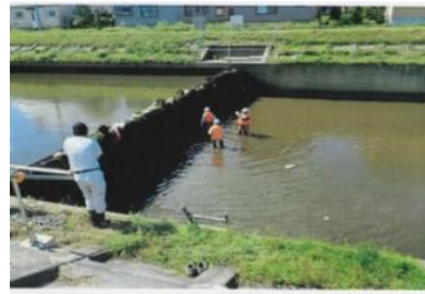
起伏ゲート故障
