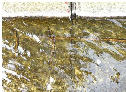
▲大和沢頭首工 エプロンの摩耗・鉄筋露出
