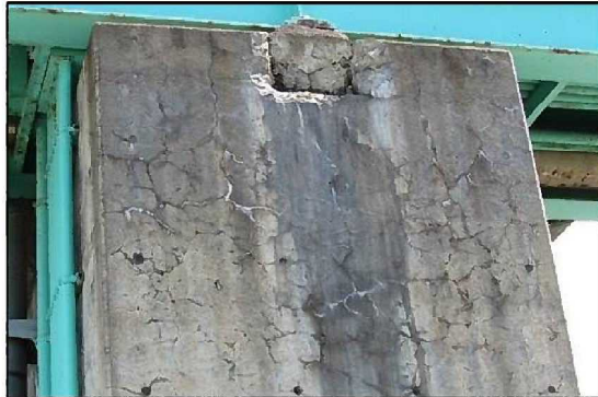
▲コンクリート堰柱の欠損、ひび割れ（銀頭首工）
