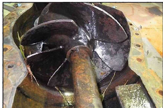
▲羽根車の発錆、腐食（川倉揚水機場）
