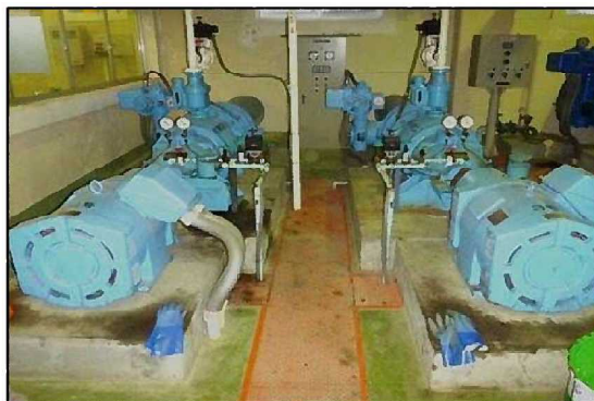
▲老朽化したポンプ設備（川倉揚水機場）
