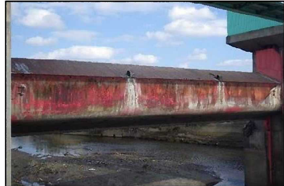
▲洪水吐ゲートの塗装劣化、発錆（銀頭首工）
