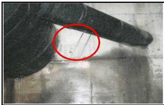
▲導水管からの漏水 (浪岡ダム)
