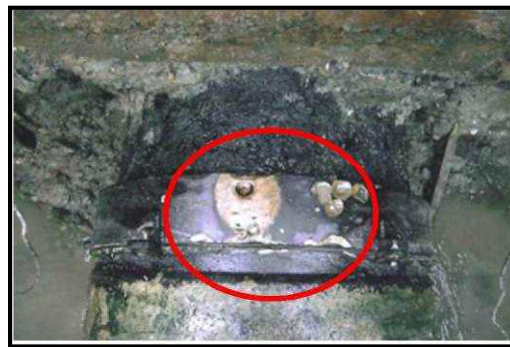
▲管水路の孔食 (松島導水路)
