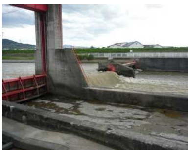
【浅瀬石川第一頭首工】 耐震性を有していない
