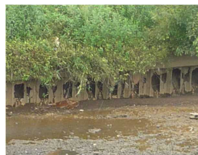
【中泉幹線排水路】 排水路軽量鋼矢板の腐食
