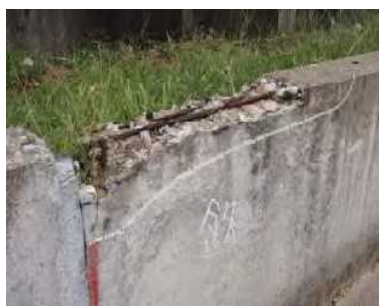
【温湯左岸第2幹線用水路】 凍害による損傷
