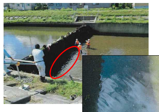
【松島頭首工】 (油圧装置の油漏れ)
