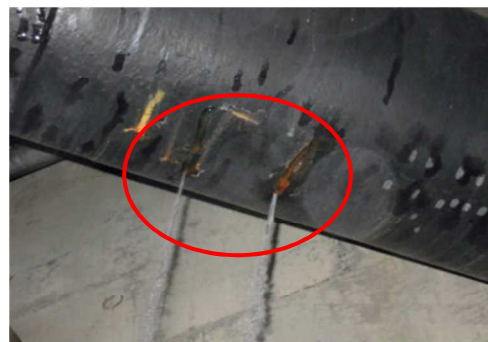
【浪岡ダム放流設備】 (放水管の漏水)
