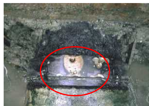
【松島導水路】 (腐食による漏水)
