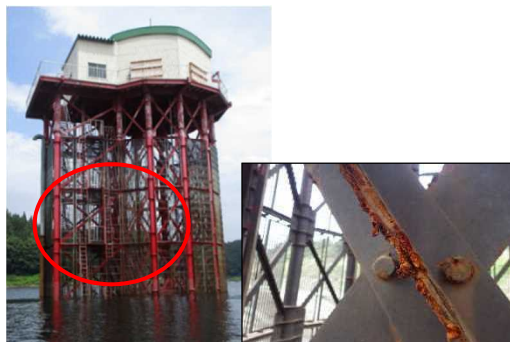
【浪岡ダム取水設備】 (鋼材の腐食・発錆)
