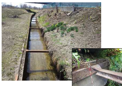
【銀幹線用水路】 (腹起し切梁の腐食・発錆)
