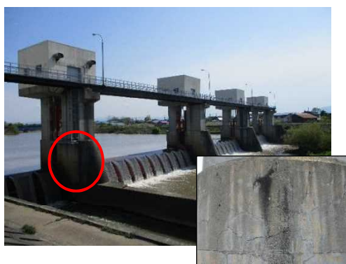
【夕顔関頭首工】 (コンクリートのひび割れ)
