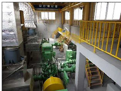
▲巻の下揚水機場内（八戸平原地区）
