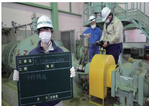
写真-1 排水ポンプの振動調査立会いの様子 (R3 潤滑油採取業務)
