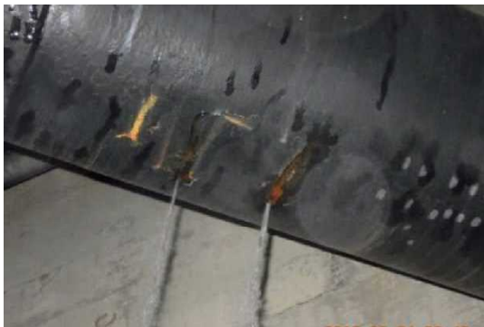
▲導水管からの漏水（浪岡ダム放流設備）
