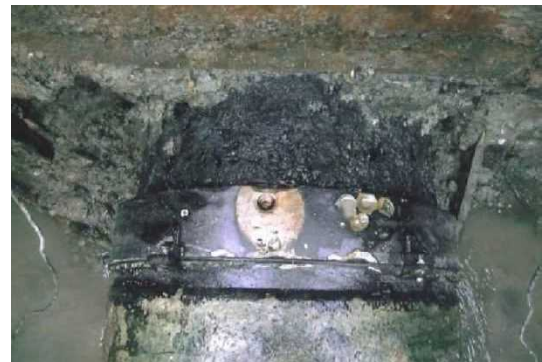
▲管水路の孔食（松島導水路）
