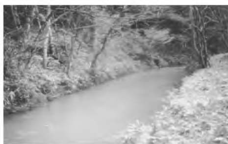
国営事業改修前の北楯大堰用水路
