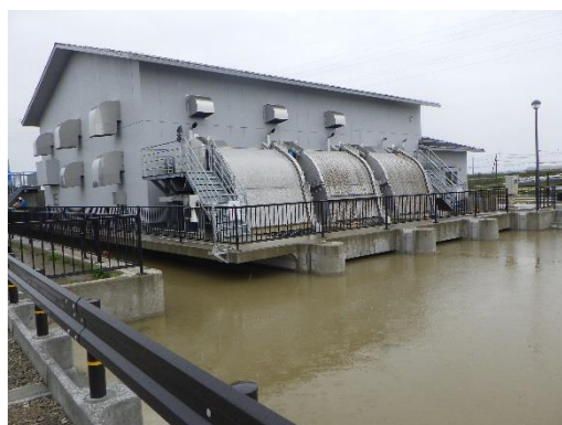
令和5年5月8日 ポンプ運転開始前
