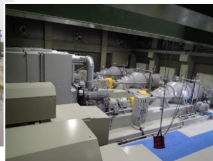
中央排水機場 ポンプ設備
