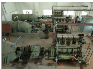
既設排水機場ポンプ設備
