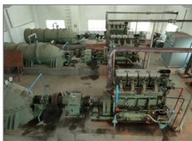
既設排水機場ポンプ設備
