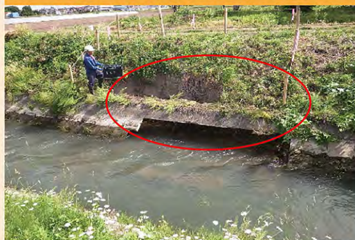
張りブロックの破損状況
