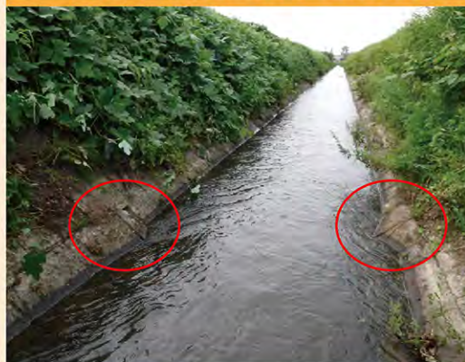
張りブロックはらみ状況
