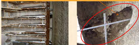
シリンダーゲートの腐食
