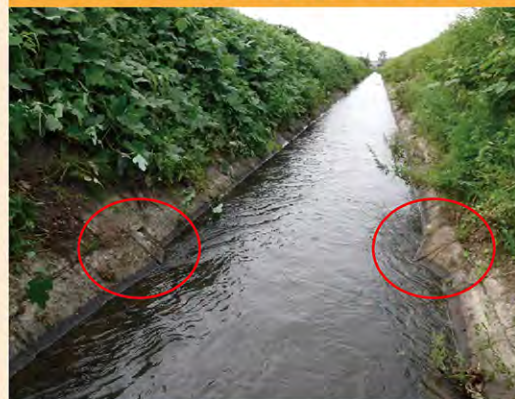
張りブロックはらみ状況
