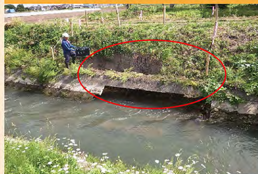
張りブロックの破損状況
