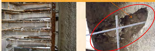
シリンダーゲートの腐食
