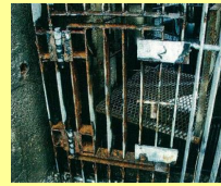
スクリーンの劣化
