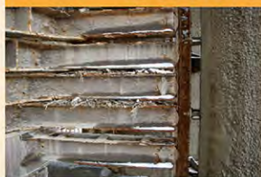
シンダーゲートの腐食
