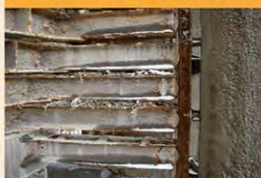
シリンダーゲートの腐食
