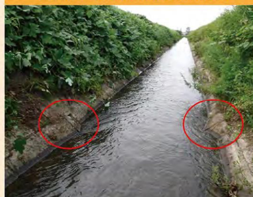
張りブロックはらみ状況
