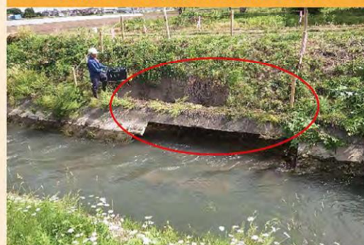
張りブロックの破損状況
