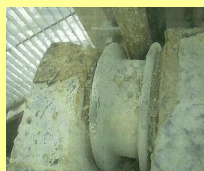
ローラーの腐食
