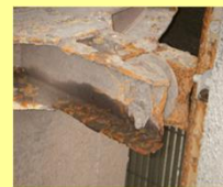
シリンダーゲートの脱落
