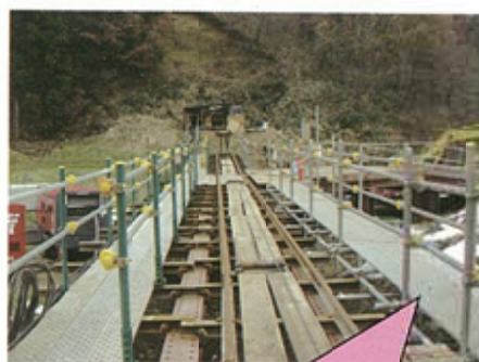
軌道と安全通路の仕切り手摺り
