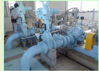
ポンプ運転を自動制御
