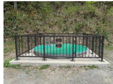
事業により整備された集水井工
