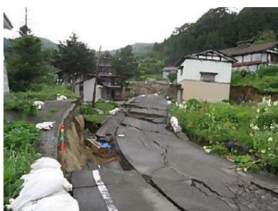
道路の被災状況（H21）
