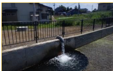
地下水ポンプ稼働状況
