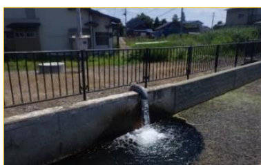
地下水ポンプ稼働状況
