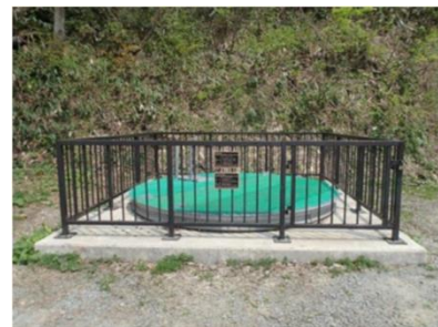
事業により整備された集水井工
