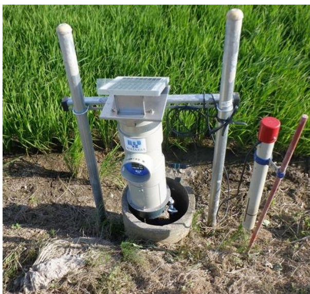
ICT自動水位給水栓の設置例 （第1弾：鶴岡市湯野沢地内）
