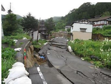
道路の被災状況（H21）
