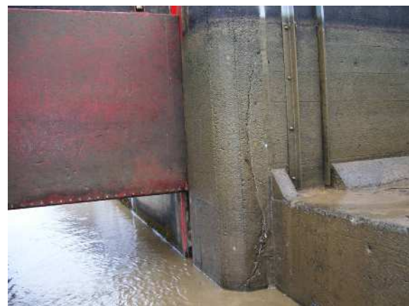
大野分水工（門柱クラック）
