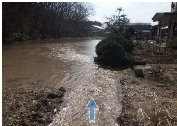
第2号導水路漏水状況②
