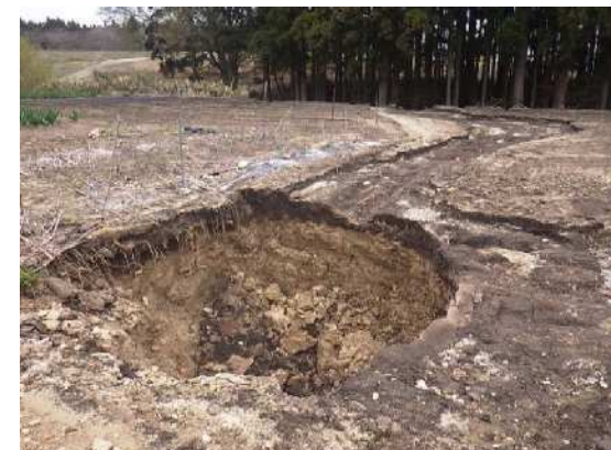
第2号導水路漏水状況③
