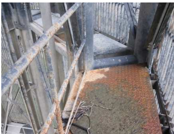
素波里取水塔（発錆）
