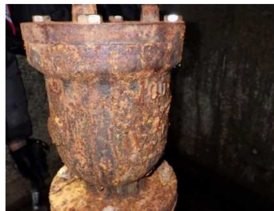
浅内支線用水路（空気弁発錆）
