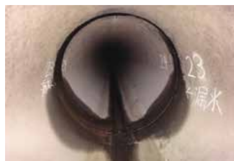
パイプライン継手部からの漏水
