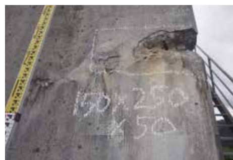
コンクリート構造物の欠損
