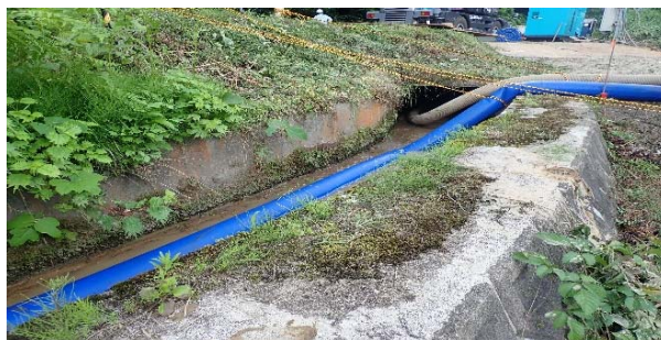
用水路へ導水
