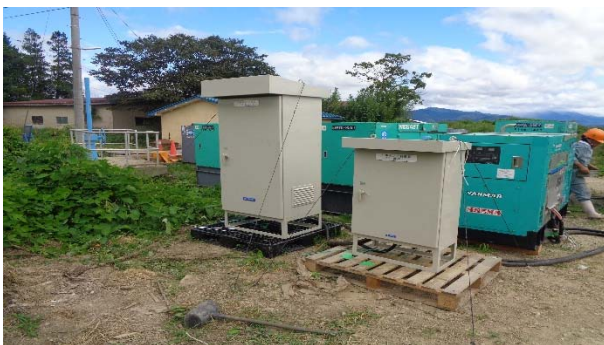
操作盤、発電機設置
