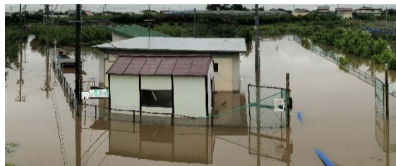
写真 浸水した中山揚水機場（三郷堰土地改良区）
