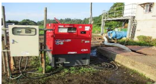
吸水槽より揚水
