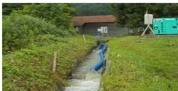
用水路へ導水
