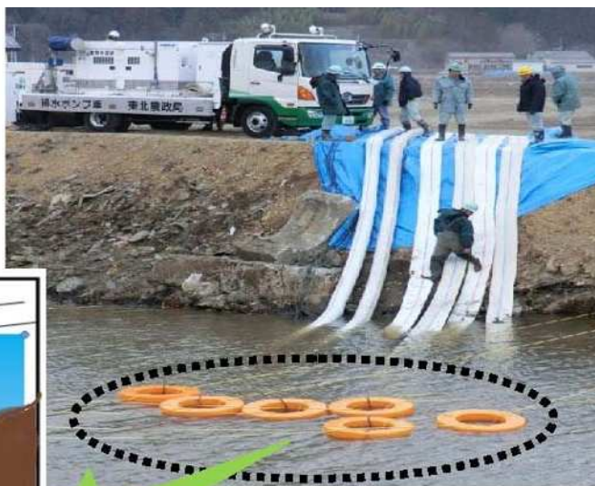
〈現地での設置状況〉
