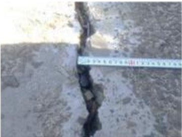
(4) ひび割れ部拡大
