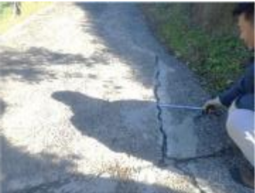
(3) ひび割れ状況
