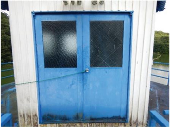
図3.3.1 上屋外観（ドア故障以外、目立った劣化無し）
