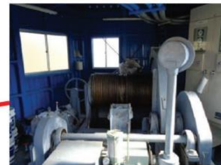
【シリンダーゲート (開閉装置、機側操作盤、休止装置)】
