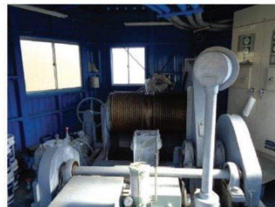
【シリンダーゲート開閉装置 と機側操作盤】
