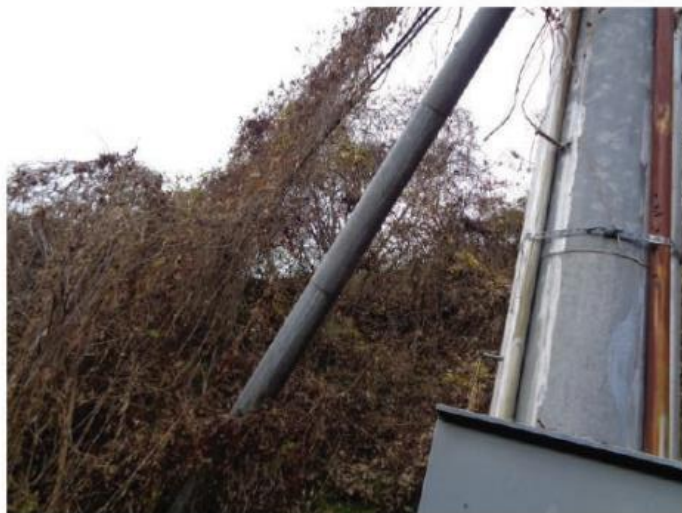
【電線支柱に絡みつく植物類】
