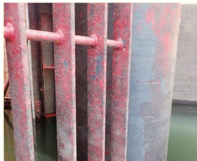
【スクリーンの塗装劣化状況】
