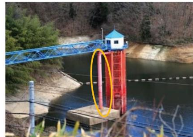
【付属設備 管理用通路(縦配管)】
