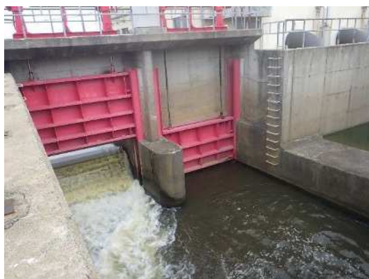
鋼製ローラーゲート
