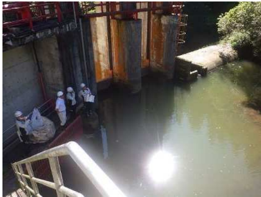
土砂吐ゲート上流 堆砂状況
