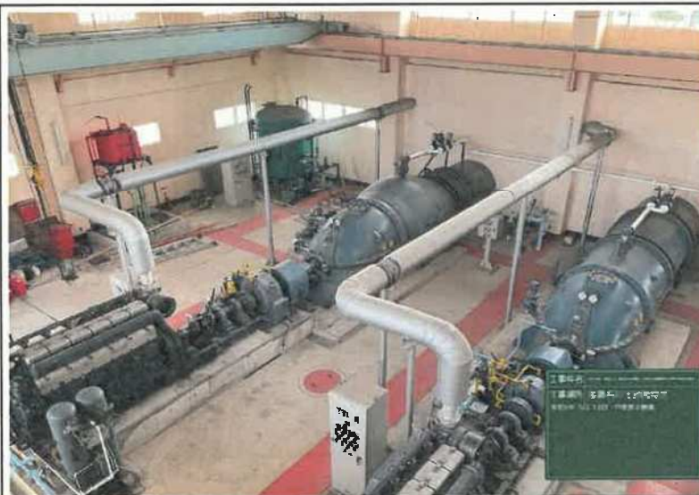
⑧ 建屋内 排水ポンプ φ1650×2台
