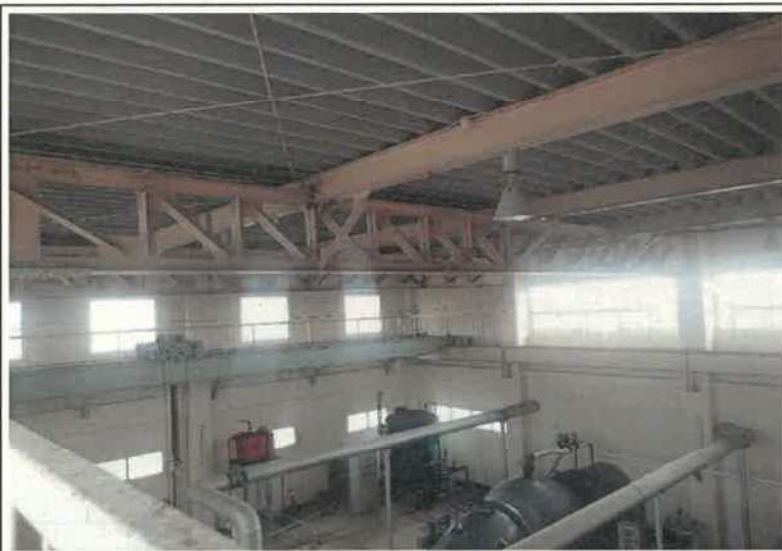
⑩ 建屋内 照明設備 クレーン
