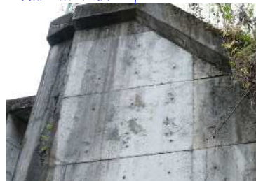
剥離・断面欠損
