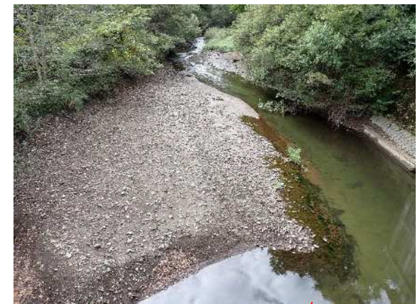
写真、上流右岸の堆砂状況
