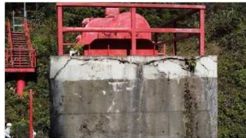
写真、凍害によるスケーリング（操作台天端の側部）
