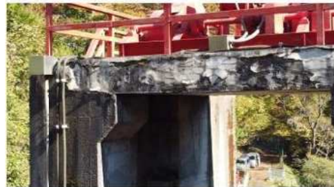
写真、凍害によるスケーリング、亀甲状ひび割れ（操作台天端の正面）
