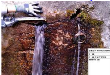
断面欠損・漏水
