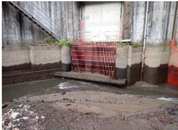
写真、取水口前面の河床洗掘
