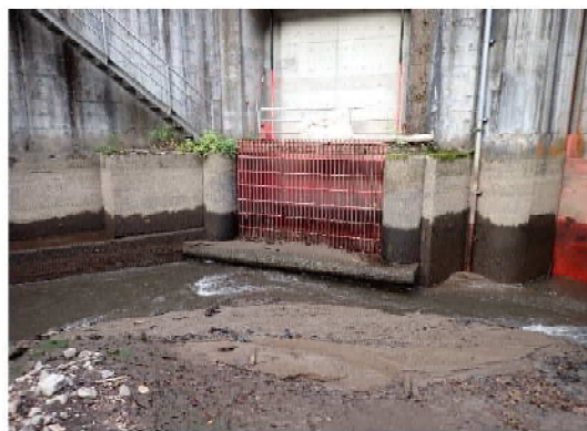
写真、取水口前面の河床沈掘
