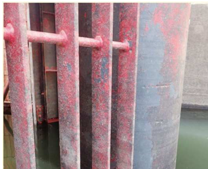
【スクリーンの塗装劣化状況】
