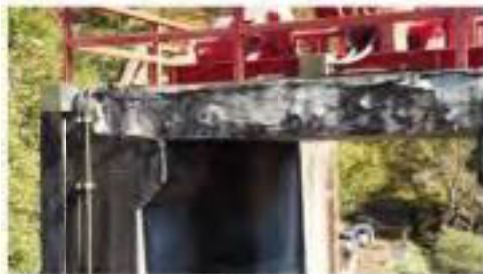
写真、凍害によるスケーリング、亀裂状況が顕著（操作台天端の断面）
