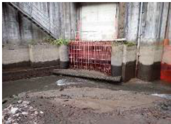
写真. 取水口前面の河床洗掘
