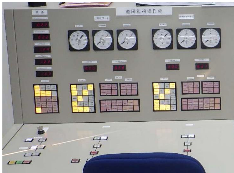
図 4-4 常時の表示（土砂吐ゲート・洪水吐②ゲート）
