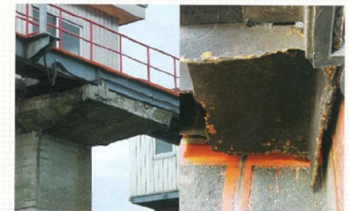
堰柱のコンクリート欠損及びゲートの腐食
