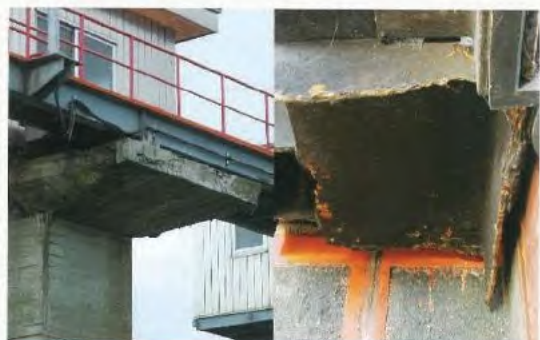
堰柱のコンクリート欠損及びゲートの腐食
