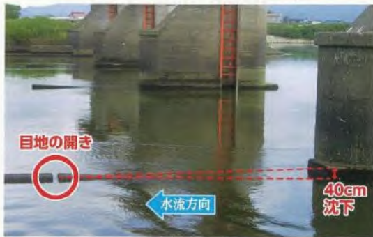
導流壁の沈下及び目地の開きが発生
