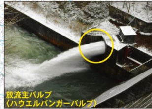
放流主バルブ (ハウエルバンカーバルブ)
