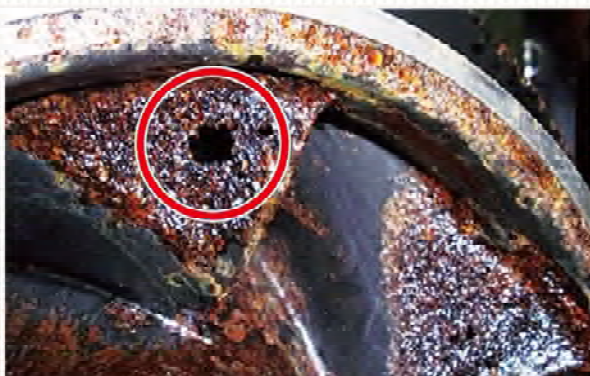
ポンプ羽根車の腐食
