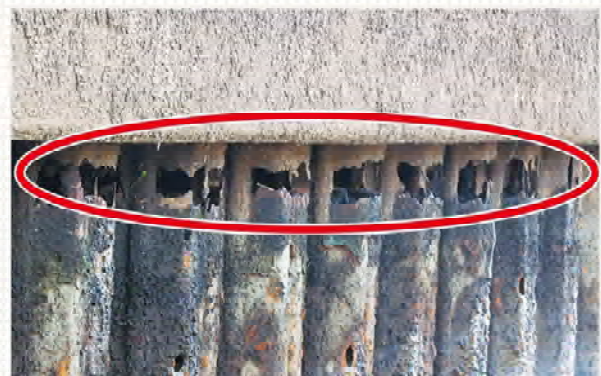
鋼矢板の腐食
