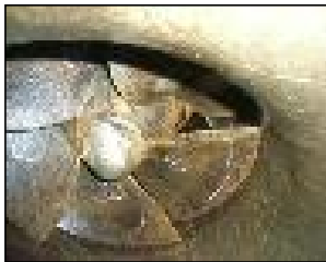
インペラの腐食 （和瀨揚水機場）
