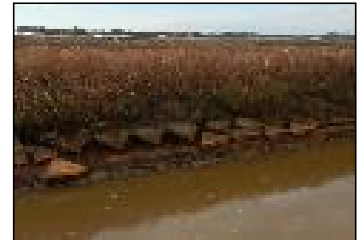
張ブロックの崩壊 （筍堀排水路）
